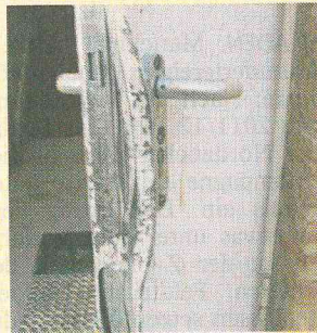
Einbruchspuren am Harlyturm. Foto: Archiv
